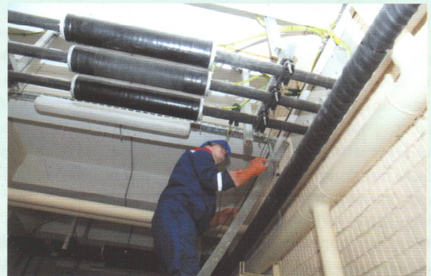
Рис. 7. Работа персонала вблизи токопроводов
