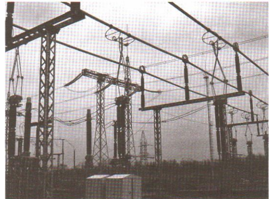
Рис. 1. Современное ОРУ с жесткой ошиновкой напряжением 330 кВ (ЗАО ЗЭТО)
