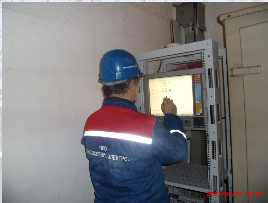
Стойка с блоком приема сигналов и компьютером
