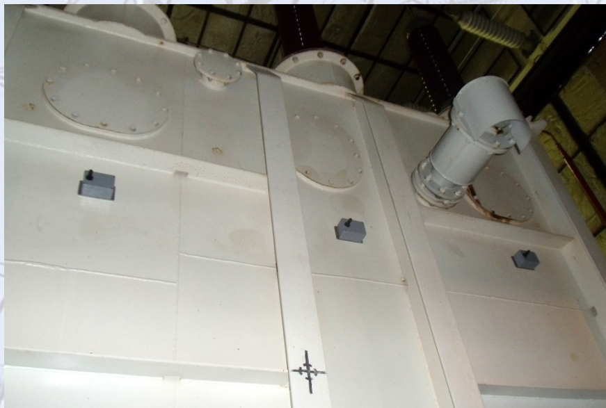
Акустические датчики с передачей сигнала по радиоканалу на баке трансформатора Т-1
