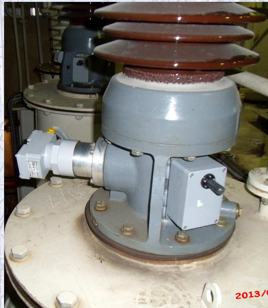
Акустические датчики с передачей сигнала по радиоканалу на фланцах вводов 110 кВ трансформатора Т-1
