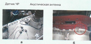
Рис. 4. Акустическая антенна на крышке бака трансформатора (а) и предполагаемое место дефекта (б)
