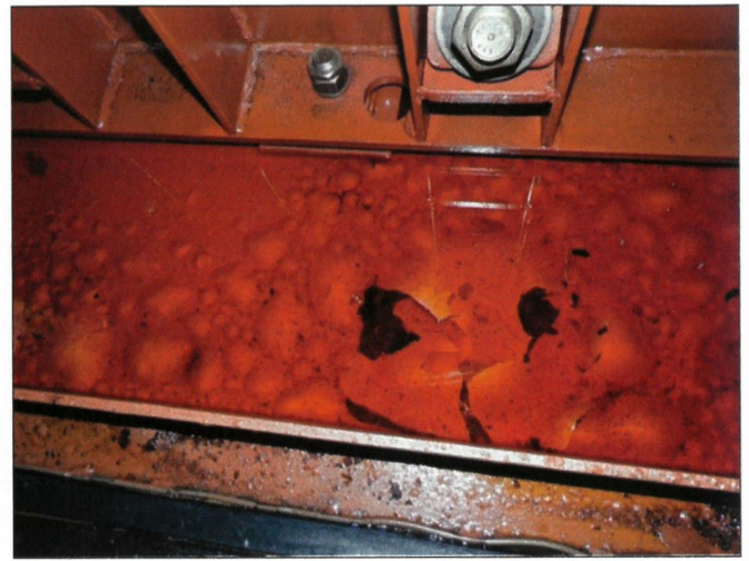
Рис. 3. Дно бака трансформатора ТРДНС-40000/35-74У1 с дефектами краски
