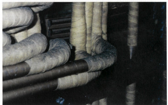
Рис. 4. Загрязнение металлической пылью отводов обмоток трансформатора ТРДЦН-80000/110 У1
