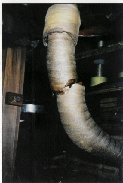
Рис. 11. Изменение концентрации водорода (а), зона акустической активности (б) и повреждение изоляции отвода ВН фазы В (в) трансформатора ТДГ-40500/110
