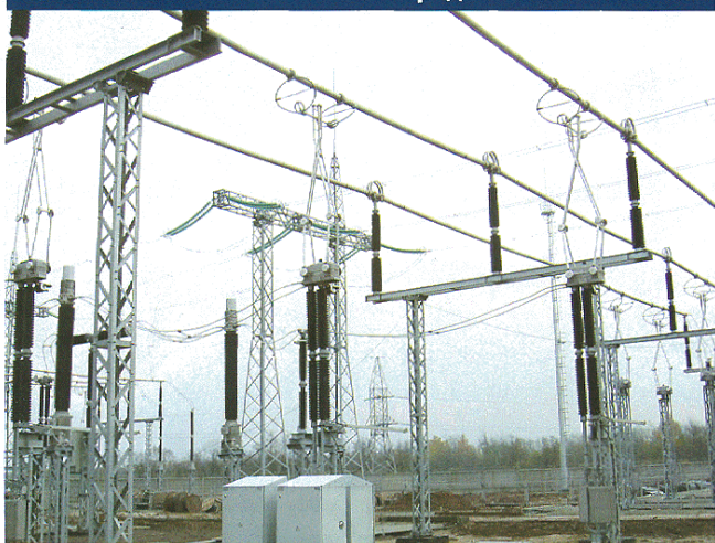
Рис. 1. Современное ОРУ с жёсткой ошиновкой 330 кВ ПС «Новгородская»
