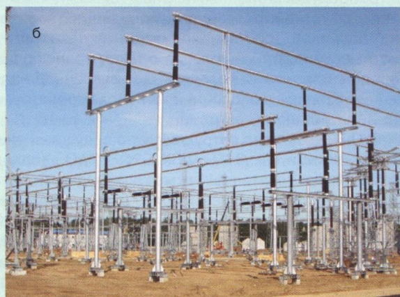
Рис. 1. Жесткая ошиновка распределительных устройств а – ПС «Ковдорский ГОК» – жесткая ошиновка производства ЗАО ПФ «КТП- Урал»; б – ПС «Грибово» – жесткая ошиновка производства ЗАО «ЗЭТО»
