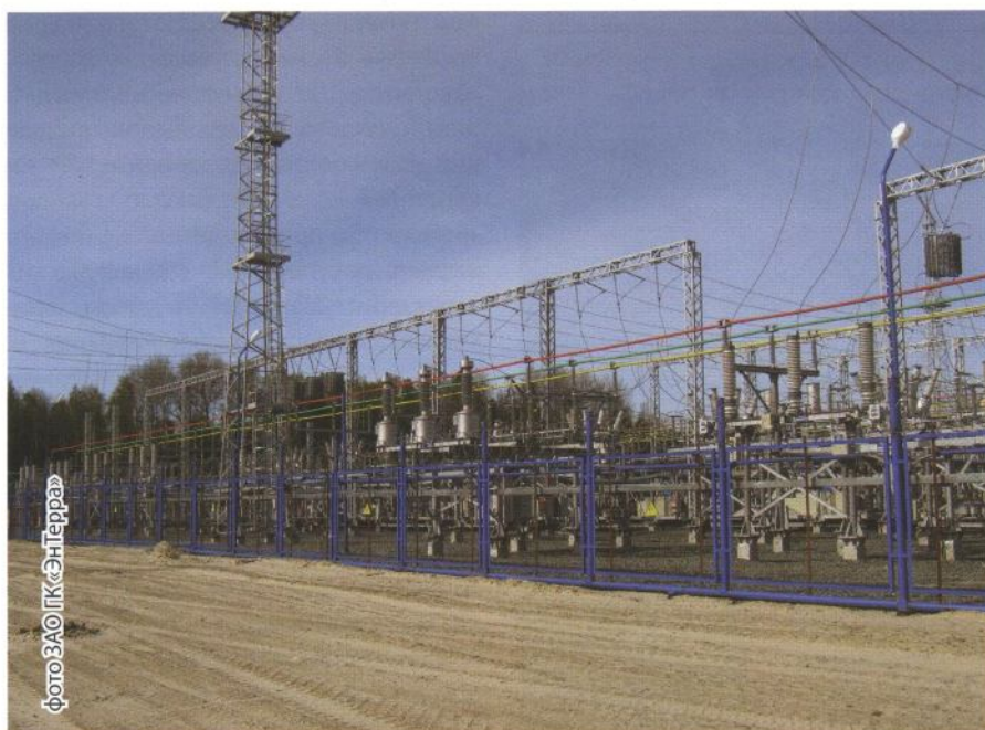
Применение жесткой ошиновки на подстанции 110 кВ «Южно-Приобская»
