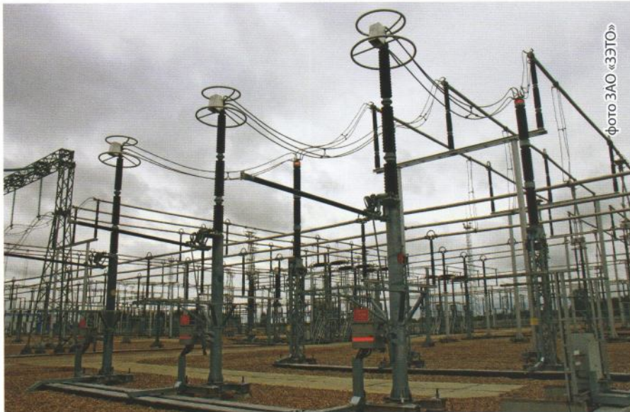
ОРУ с использованием жесткой ошиновки 500 кВ на ПС «Грибово» 750/500/220/110/10 кВ ОАО «ФСК ЕЭС»
