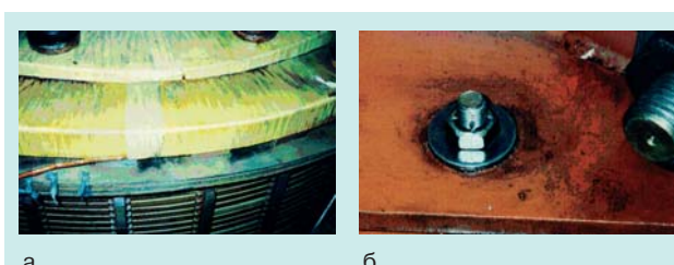
Рис. 4. Загрязнение активной части трансформаторов ТДЦ-250000/500 углеродом
