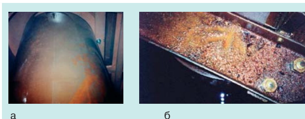
Рис. 3. Загрязнение активной части трансформаторов
