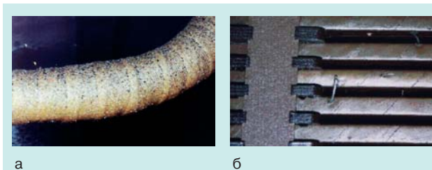
Рис. 2. Загрязнение активной части трансформаторов стальной стружкой
