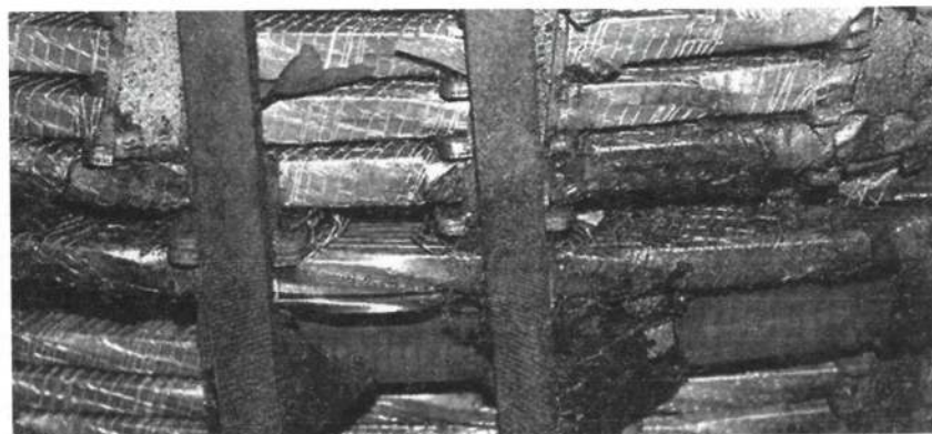
Рис. 10. Деформация витков обмотки НН1 однофазного трансформатора 500 кВ Fig. 10. Radial deformation of LV winding turns of single-phase 500 kV transformer
